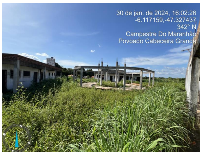
Figura 27 –Bloco central com bastante vegetação em estruturas de concreto. Fonte: elaboração própria.
