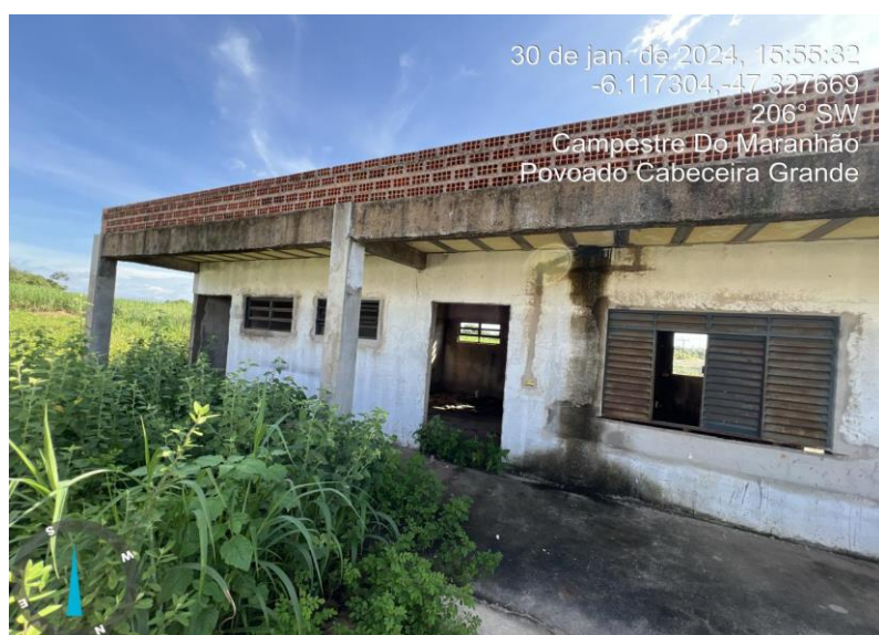
Figura 19 – Vista frontal do bloco de serviço presença de vegetação. Fonte: elaboração própria.
